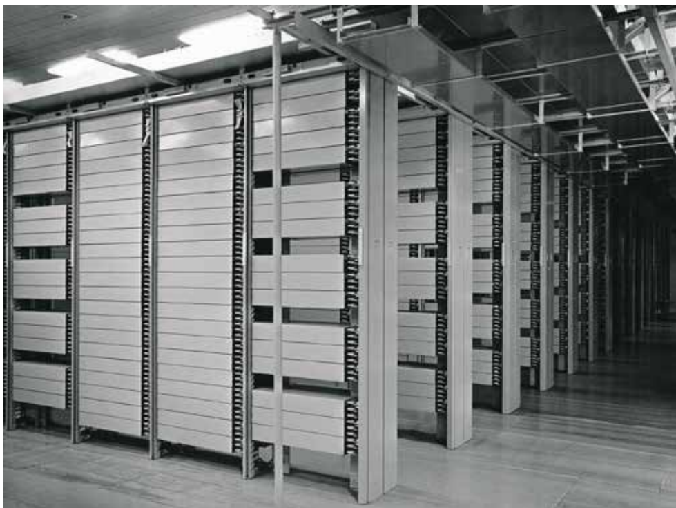
Mezinárodní ústředna třetí generace AKE-13 od firmy LM Ericsson v Ústřední telekomunikační budově v Praze, foto: Marie Bonaventurová, 1985, sbírka Poštovního muzea
